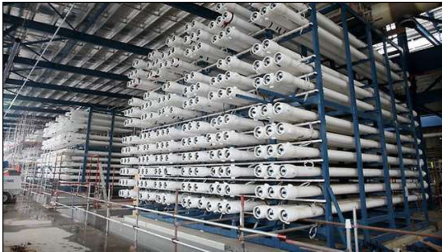
Figura 2.5 Bastidores de osmosis inversa. [7]
