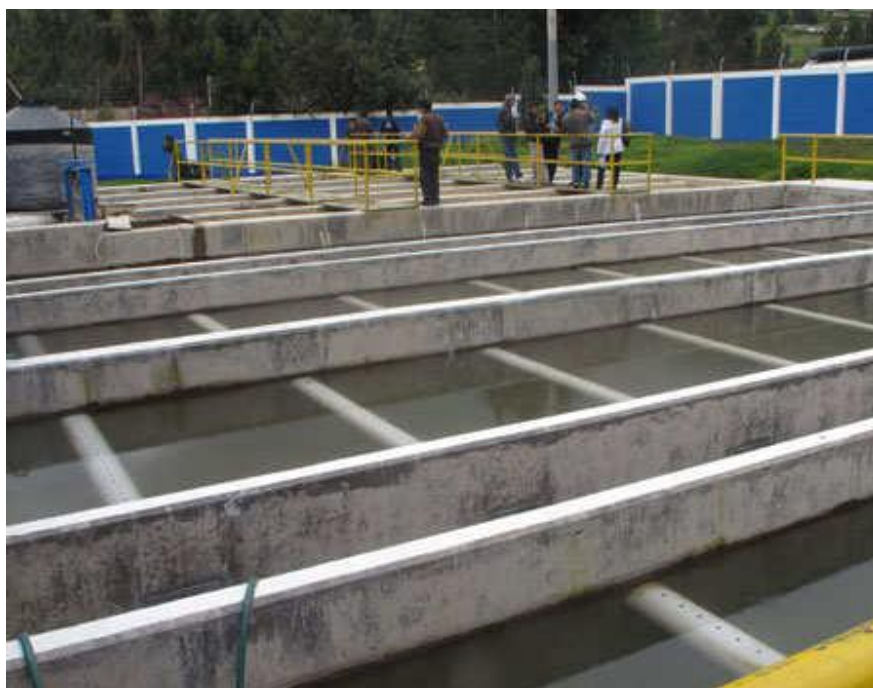
Figura 4: Planta de tratamiento de agua de Vilcacoto FUENTE: SUNASS (2014)
