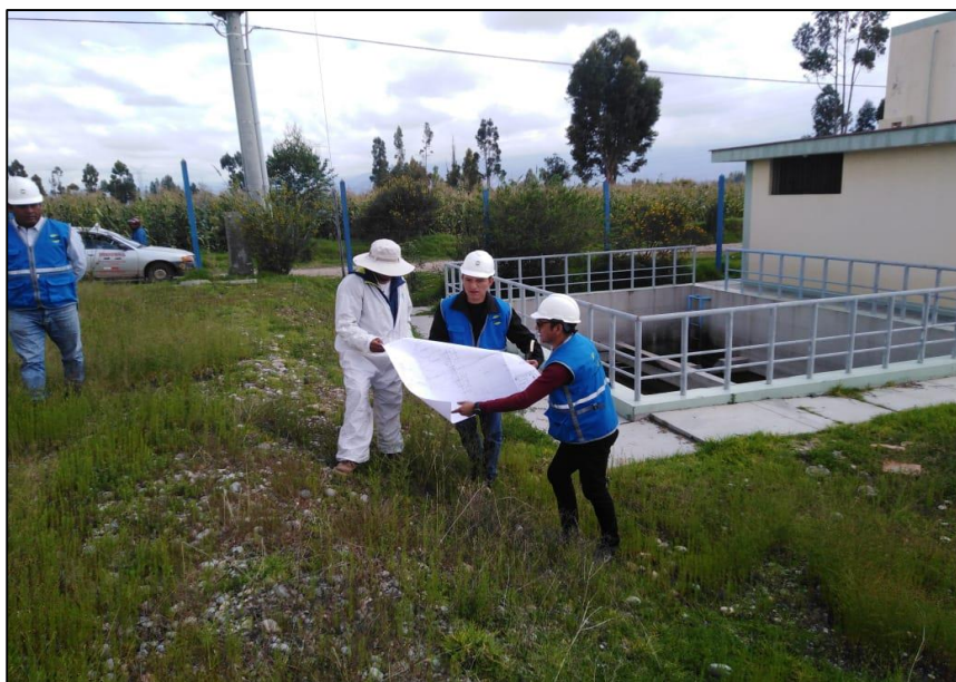
Figura 27. Planta de tratamiento de aguas residuales de la localidad de Chupaca – Junín.
