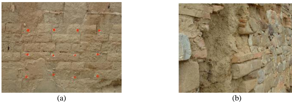
Figura 2.14 Muros de las construcciones de Aliano (a) adobe (b) adobe y sillar. Adaptado de (Liberatore, et al., 2006)
