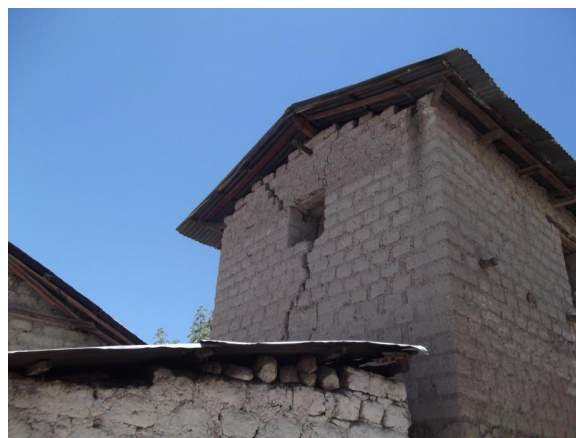
Figura 4.7. Agrietamiento diagonal siguiendo la línea de juntas de mortero.
