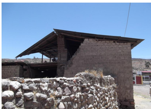
Figura 4.8. Colapso parcial de tímpano de adobe.
