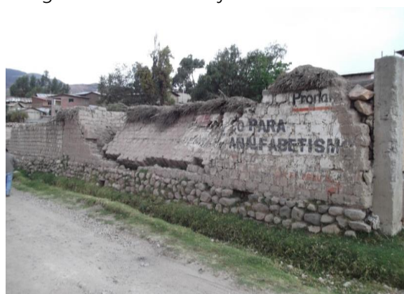
Figura 4.9. Volteo lateral de muro de cerco.
