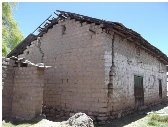
Figura 4.6. Agrietamiento vertical en encuentro de muros.
