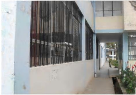
Deflexiones y pandeo de ventanas
