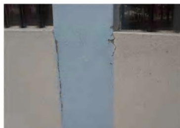
Fisuras en unión tabique muro
