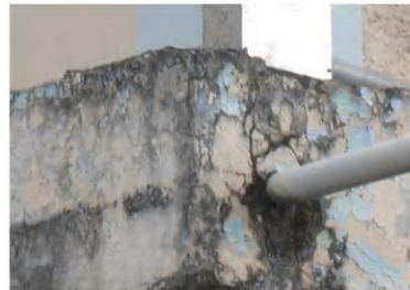
Humedad y deterioro del concreto
