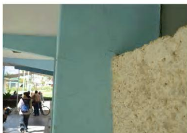
Fisuras en Columnas
