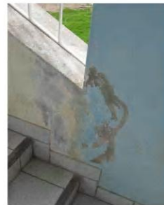
Humedad en unión viga - columna
