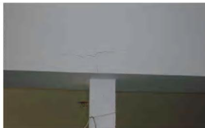
Fisuras en Vigas Apuntaladas
