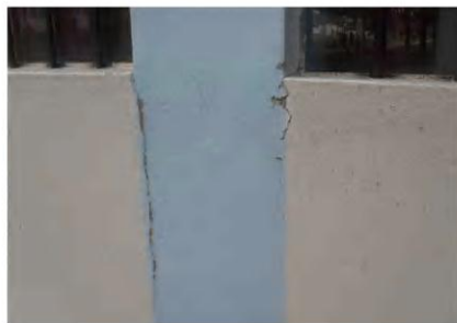
Fisuras en unión tabique muro
