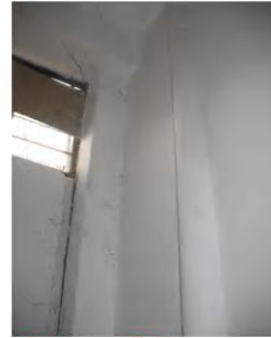
Grietas en Tabiques
