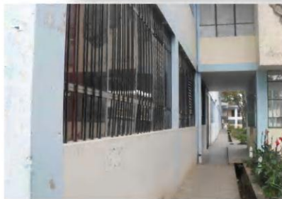
Deflexiones y pandeo de ventanas
