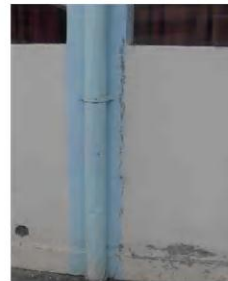
Fisuras en unión tabique muro
