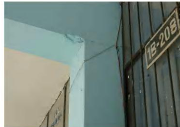
Fisuras en Vigas en Voladizo
