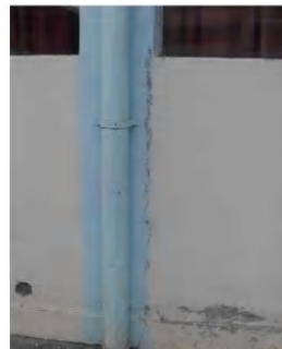
Fisuras en unión tabique muro
