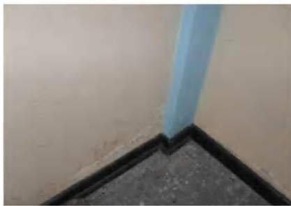
Humedad en paredes
