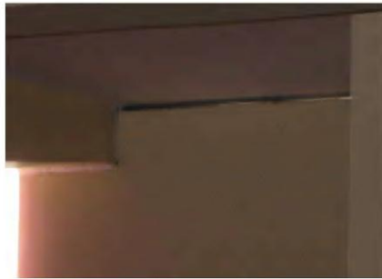
Fisuras en unión Tabique - Portico
