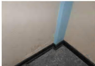
Humedad en paredes
