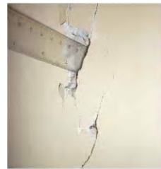
Grietas en Tabiques
