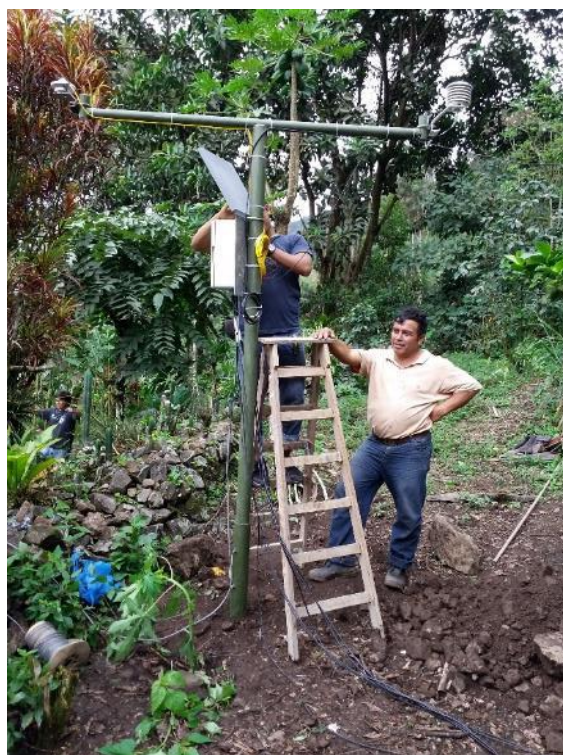
Figura 97 Instalación de los sensores termo higrómetro Fuente: Elaboración propia.
