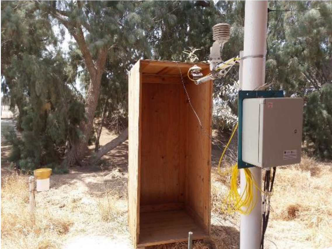
Figura 77 Estación a modo de prueba en Udep Fuente: Elaboración propia.
