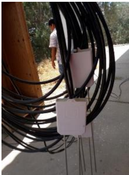
Figura 31 Sensores de humedad Fuente: Elaboración propia.
