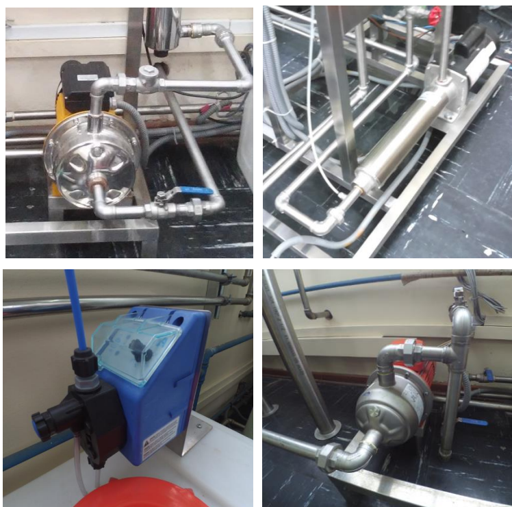
Figura 3.4. Bombas de baja presión (superior izquierda), alta presión (superior derecha), dosificación (inferior izquierda) y recirculación (inferior derecha).
