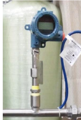
Figura 3.14. Transmisor de temperatura.
