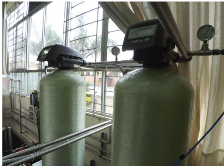
Figura 3.7. Filtro multimedia y filtro carbón
