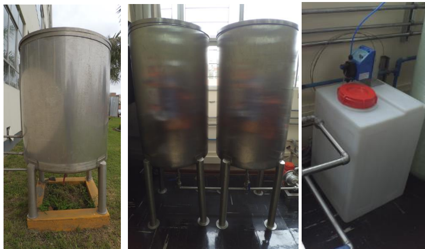
Figura 3.3. Tanques de alimentación (izquierda), tanque de agua producto y agua de rechazo (centro), y tanque de ácido (izquierda).
