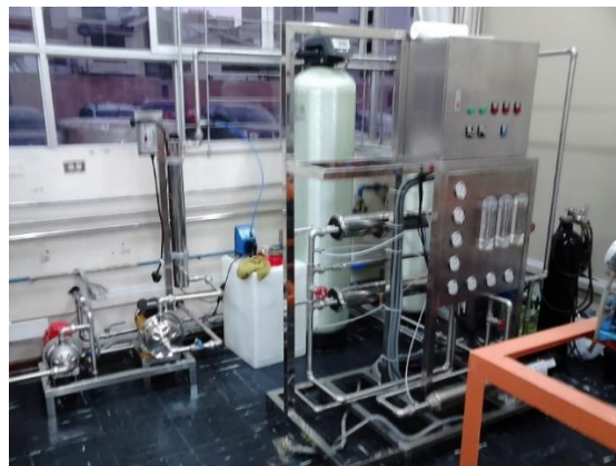
Figura 3.2. Planta piloto de desalinización por ósmosis inversa.
