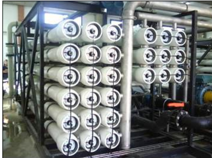
Figura 2.4. Bastidor de ósmosis inversa
