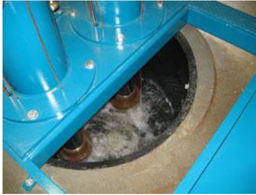
Figura 2.2. Estación de bombas de pozo húmedo.
