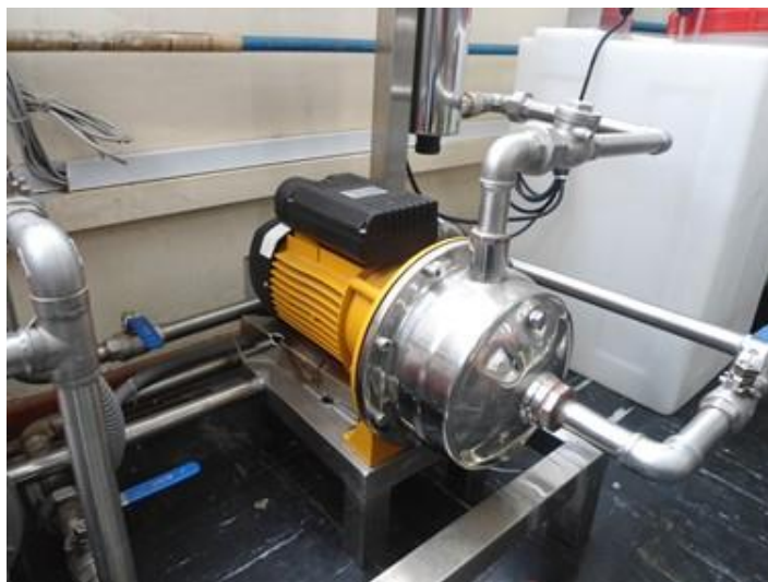
Figura 4.18. Bomba de alimentación de agua salina.
