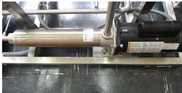
Figura 4.23. Bomba de alta presión para ósmosis inversa.
