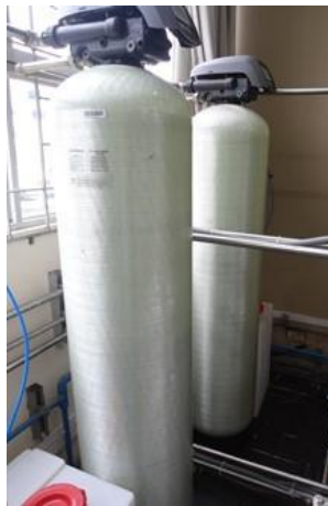
Figura 4.20. Tanques contenedores de filtros multimedia y de carbón.
