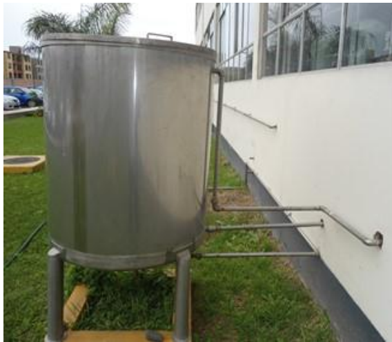
Figura 4.17. Tanque de almacenamiento de agua salina.
