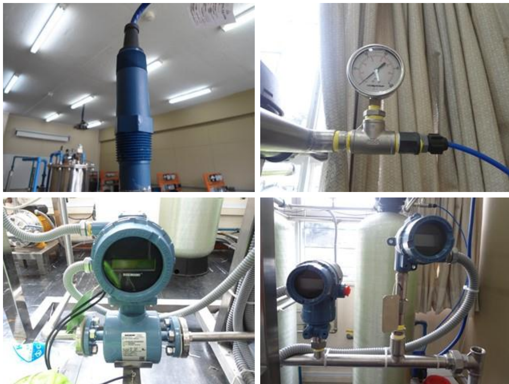
Figura 4.26. Elementos de instrumentación del bastidor de ósmosis inversa.
