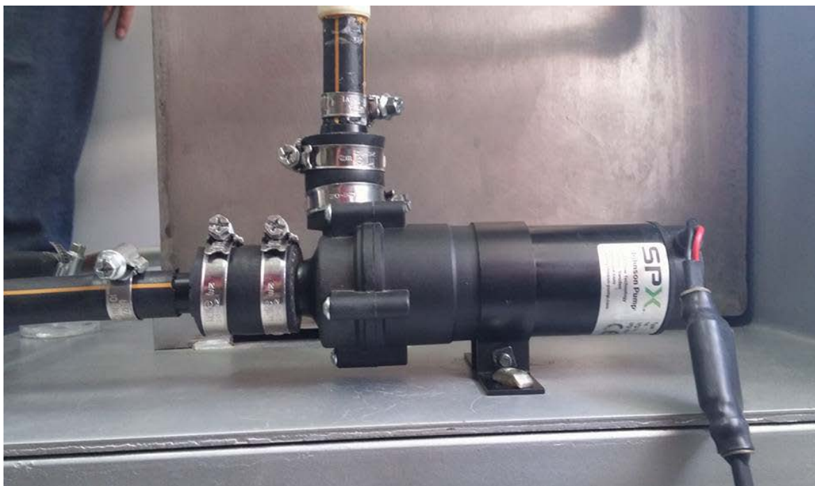
Figura 4. Electrobomba montada en el modulo
