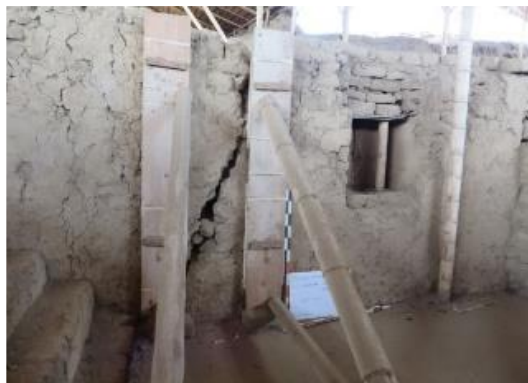
(b) Grietas severas en los muros
